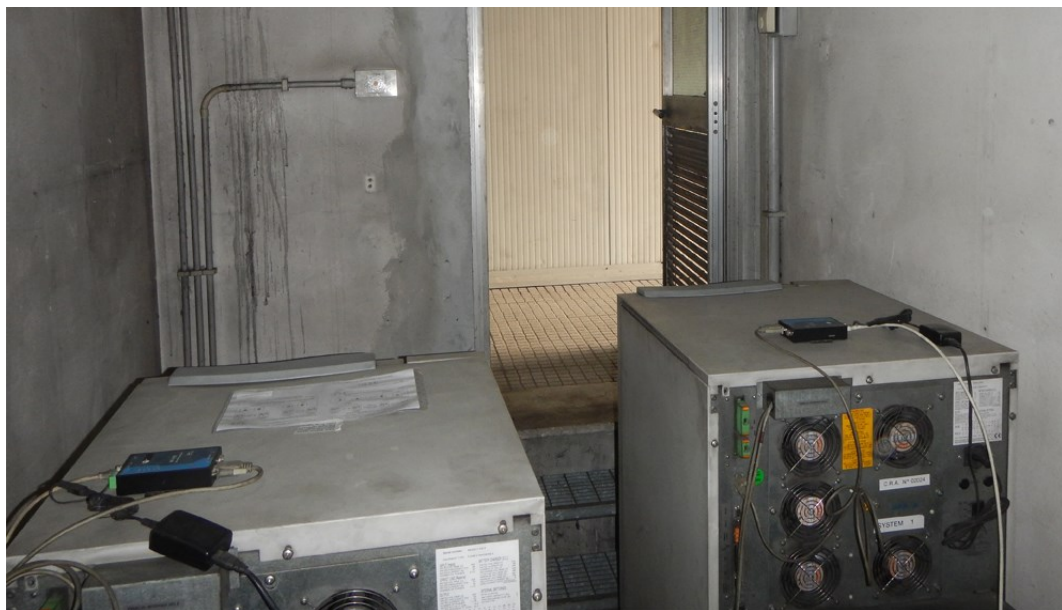
FIGURA 6 PARTICOLARE DELLE APPARECCHIATURE E DEI RELATIVI ACCESSORI DA RITIRARE.
