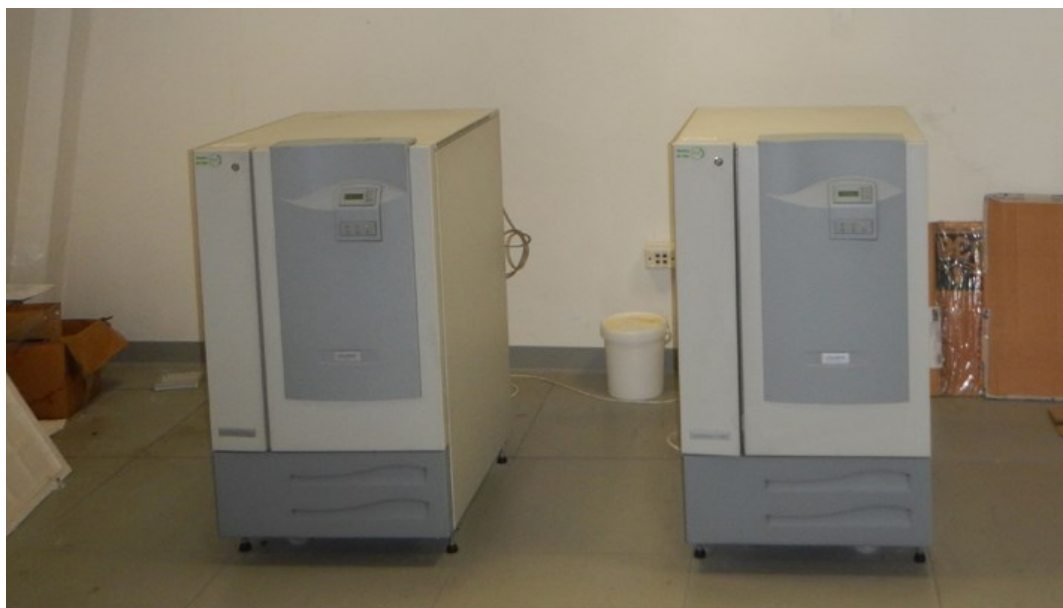
FIGURA 9 LOCALE DI CONSEGNA E OBSOLETE APPARECCHIATURE DA SOSTITUIRE E RITIRARE
