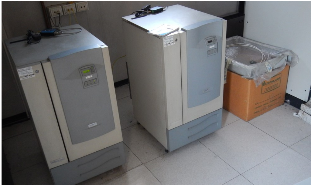
FIGURA 11 LOCALE DI CONSEGNA E LE OBSOLETE APPARECCHIATURE DA SOSTITUIRE E RITIRARE.
