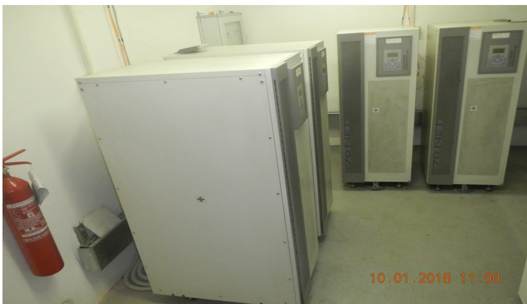
FIGURA 15 LOCALE DI CONSEGNA E OBSOLETE APPARECCHIATURE DA SOSTITUIRE E RITIRARE
