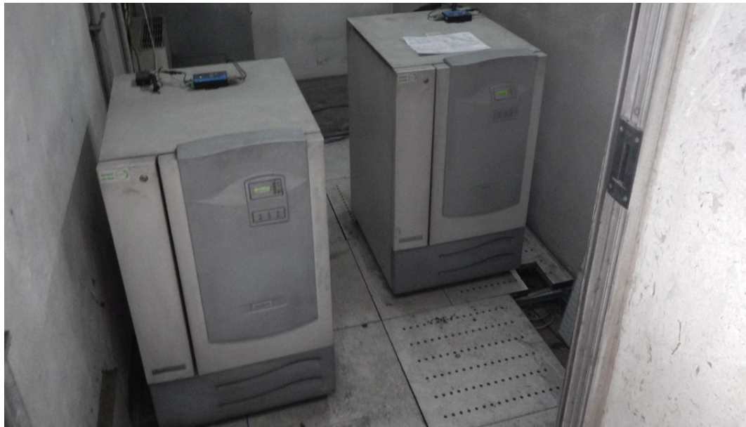
FIGURA 5 LOCALE DI CONSEGNA E OBSOLETE APPARECCHIATURE DA SOSTITUIRE E RITIRARE
